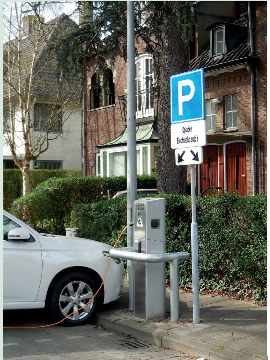
Oplaadpalen voor elektrisch vervoer worden momenteel op aanvraag van de lokale gebruiker geplaatst.
